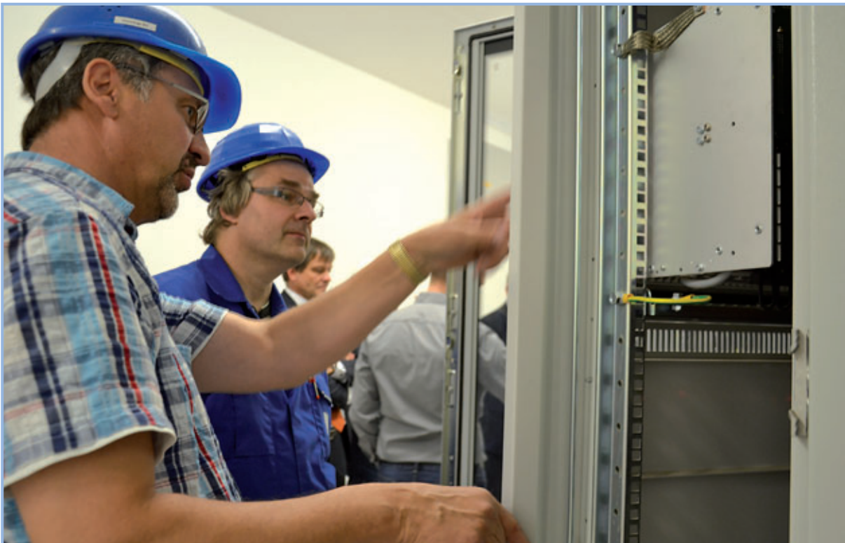
Wolfgang Hochgräf, Meister Erzeugung der Servicegesellschaft Sachsen-Anhalt Süd mbH (vorn) und Jens Uwe Stich bei einer Einweisung zur Funktion der Prozessleittechnik im Umspannwerk Nord.
