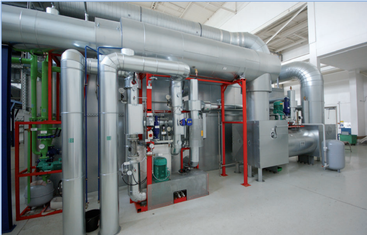
Das neue Blockheizkraftwerk Weißenfels-Süd.
